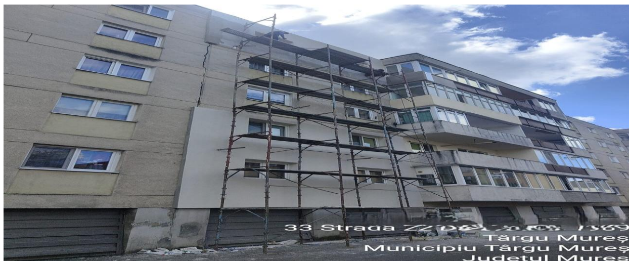
Lucrare de reabilitare termică fără Autorizație de Construire
