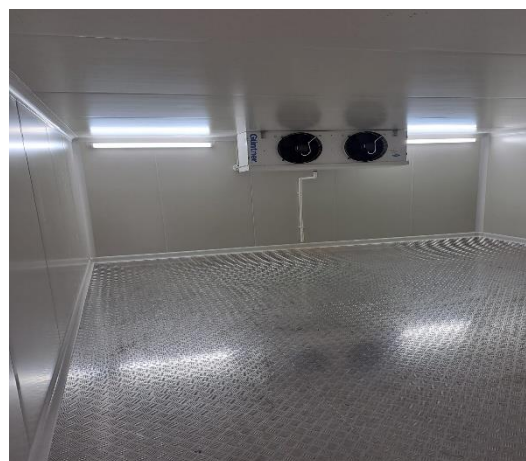
Foto: noua cameră frigorifică
