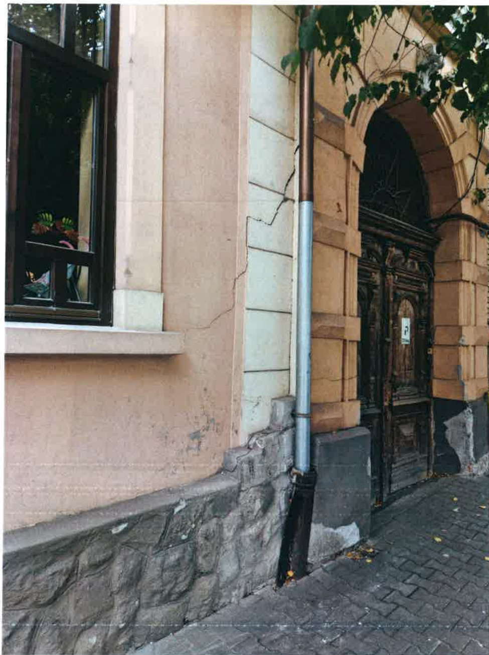
Fațada principală, partea stângă cu zona degradărilor structurale
