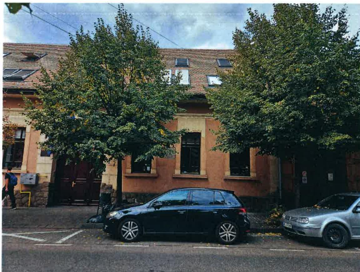
Fațada principală, partea stângă cu zona degradărilor structurale
