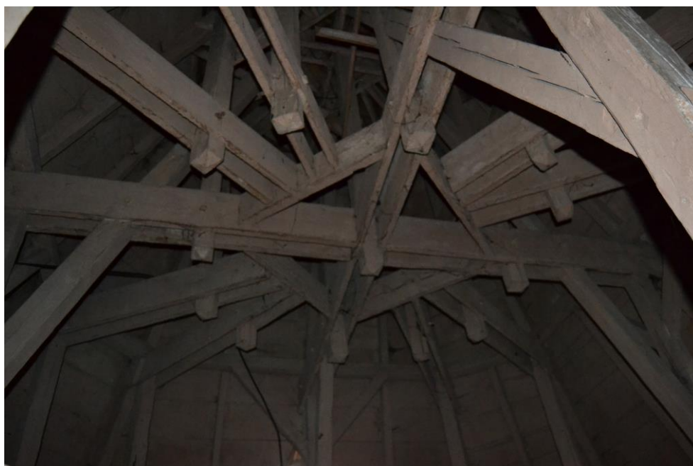
Pod: elementele structurale ale șarpantei nu au fost afectate de infiltrații de apă pluvială.
