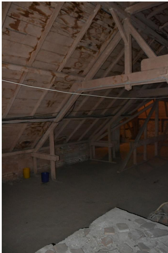
Pod, zonă afectată de infiltrațiile de apă.
