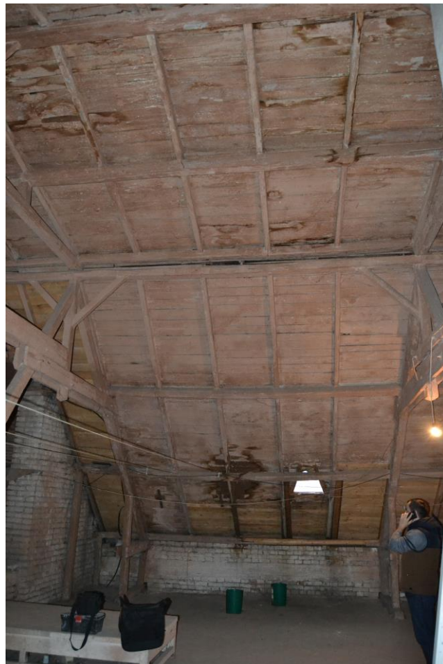
Infiltrațiile de apă au fost punctuale și au afectat în primul rând stratul de scândură.
